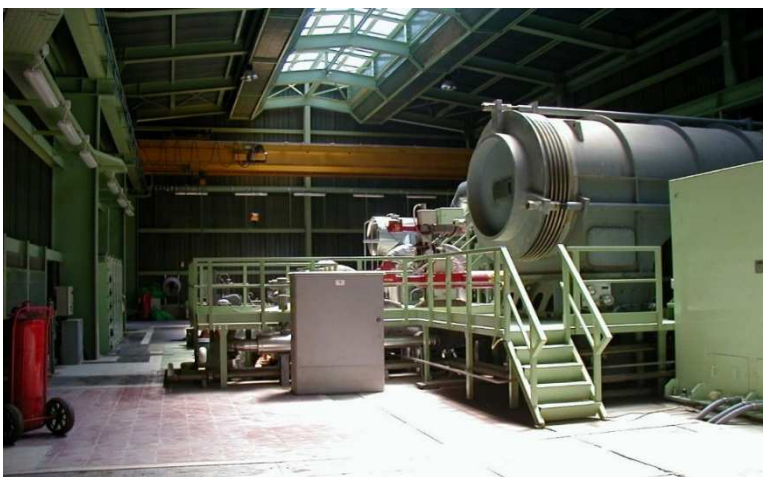
Figura 3 – interno di una centrale geotermica
