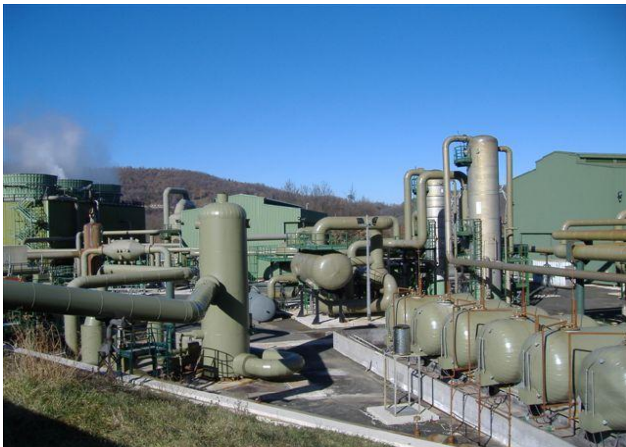
Centrali Travale 3 e Travale 4 - in comune di Montieri (Gr), equipaggiate con impianto AMIS.
