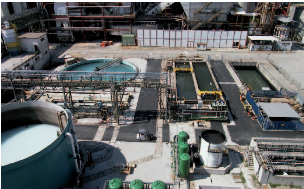
Figura 8 Impianto integrato di trattamento delle acque
