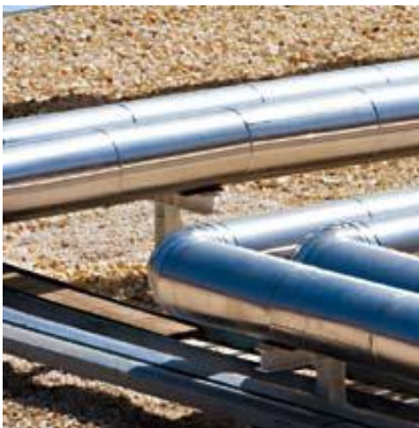
Figura 9 - Visione parziale del piping - impianto solare termodinamico
