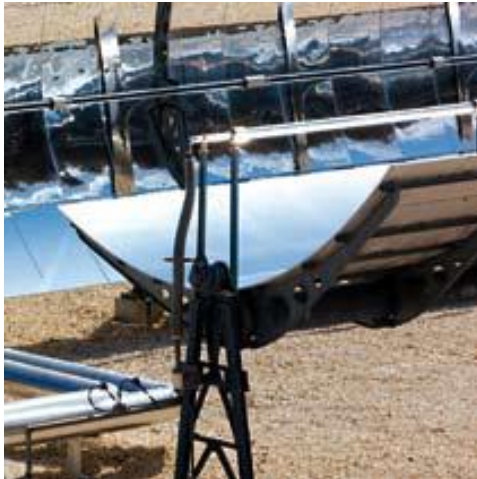
Figura 8 - Collettori impianto solare termodinamico
