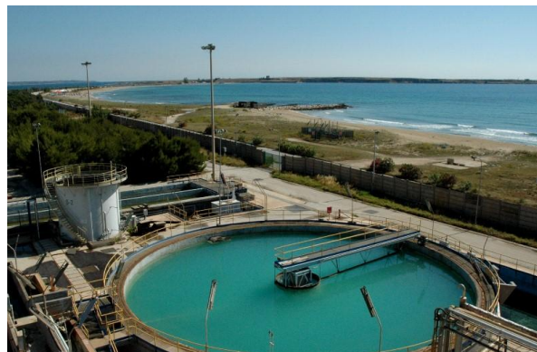
Figura 15 - Impianto integrato di trattamento delle acque
