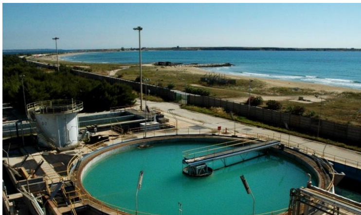
Figura 9 - Impianto integrato di trattamento delle acque
